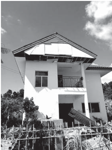
ภาพที่ 15: สภาพบ้านที่พัง และไม่ได้รับการซ่อมแซม
